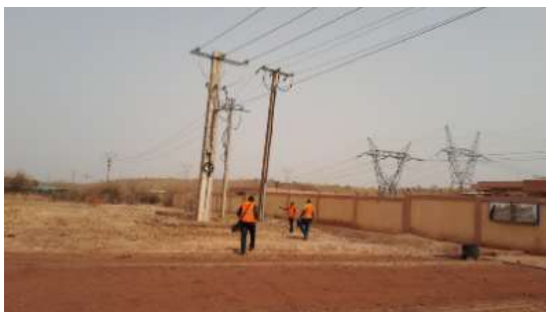
Figure 4 : Poste de Kita
