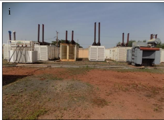
Une vue du site d'accueil du Système de Stockage d'énergie, présence de groupes électrogènes
