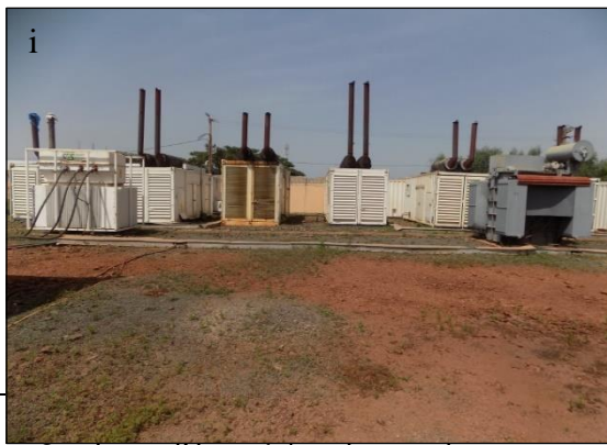
Stockage d'énergie), présence de groupes électrogènes
