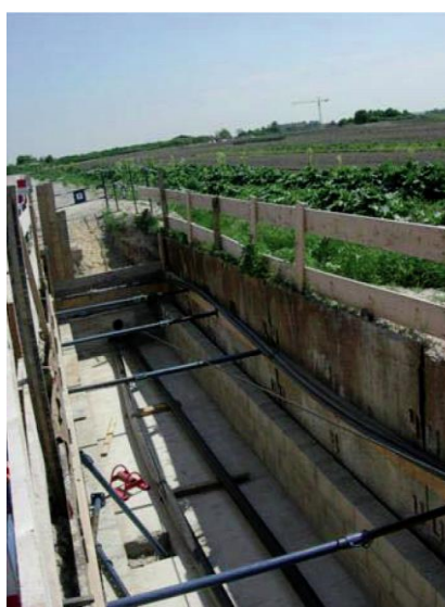
Exemple d'une chambre de jonction
