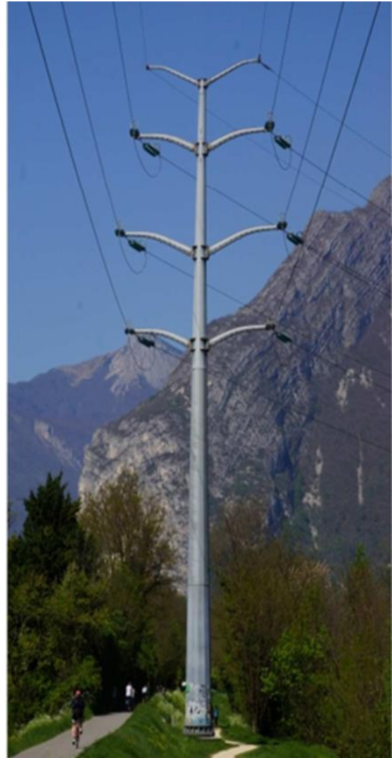
Pylône monopode d'angle (type Muguet)
